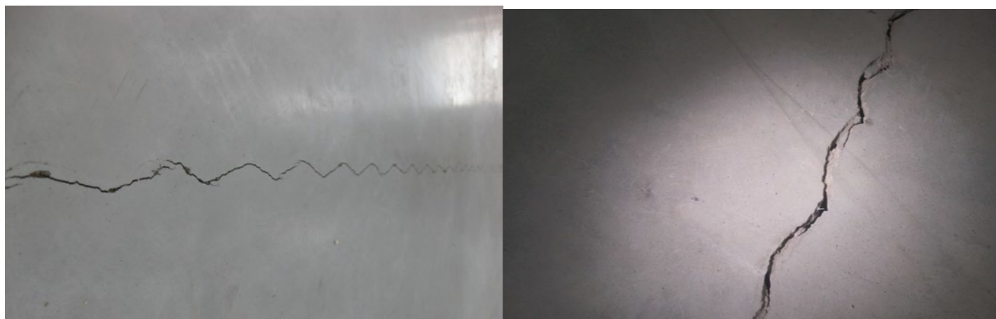
DÅRLIG AFSLUTNING !!! Dårligt udført entreprenørarbejde
