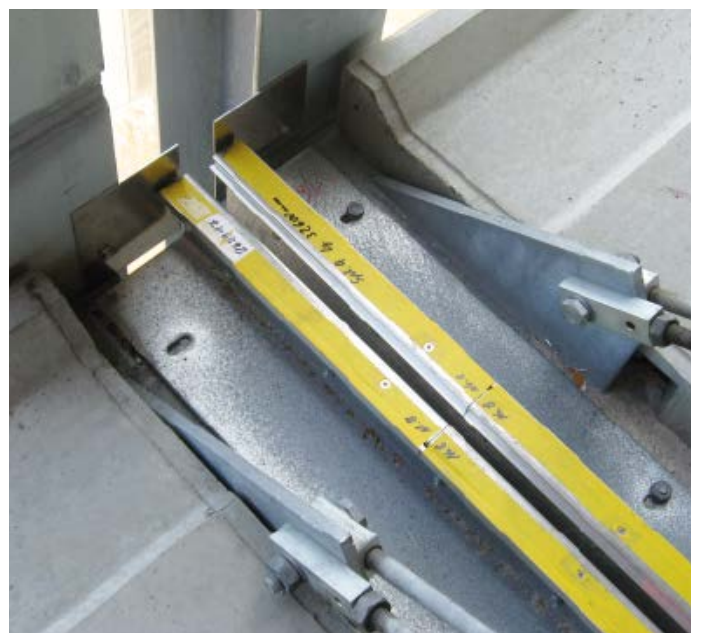
Parking deck Weiterstadt –FP 90
